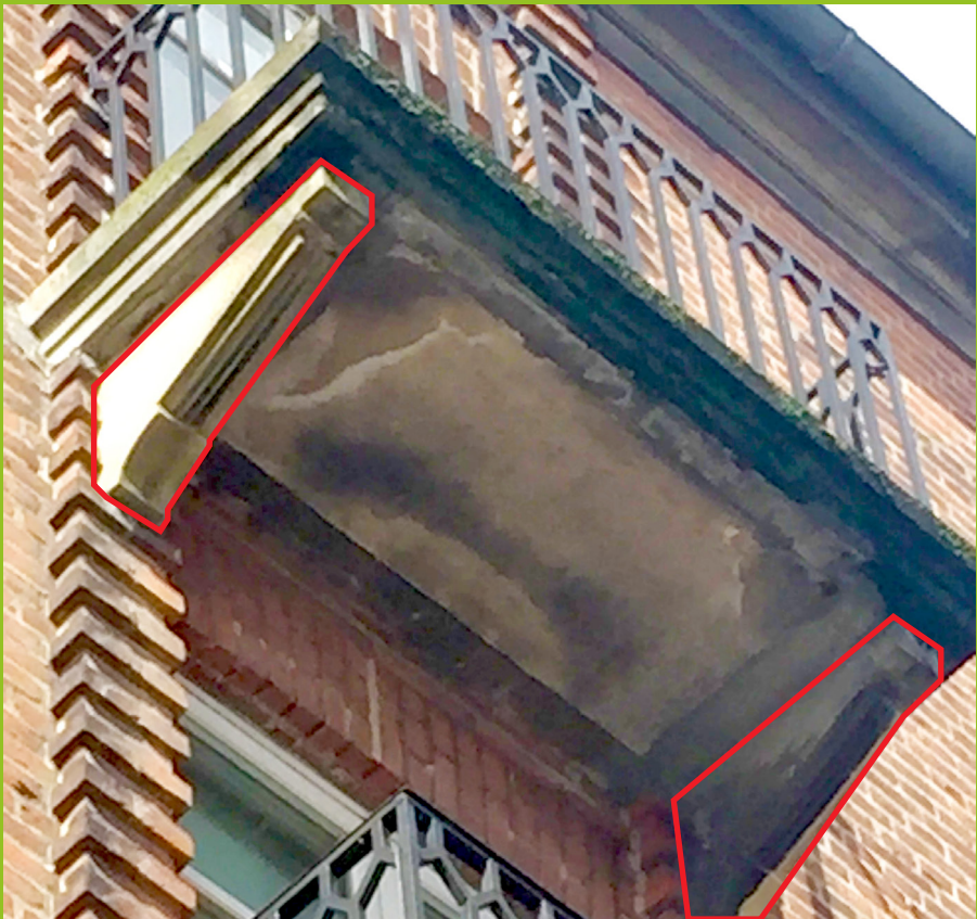
Figur 2: Altan med udliggerjern, som er udført med "pyntekonsoller" (markeret på foto), der kan give anledning til at tro, at det statiske system er anderledes end det i virkeligheden er.
