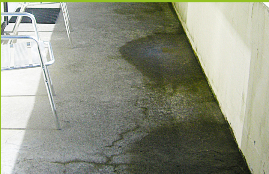
Figur 9: Altan hvor afvanding ikke foregår korrekt. I dette tilfælde opstår vandpytter mod brystning ved altanens forkant.
