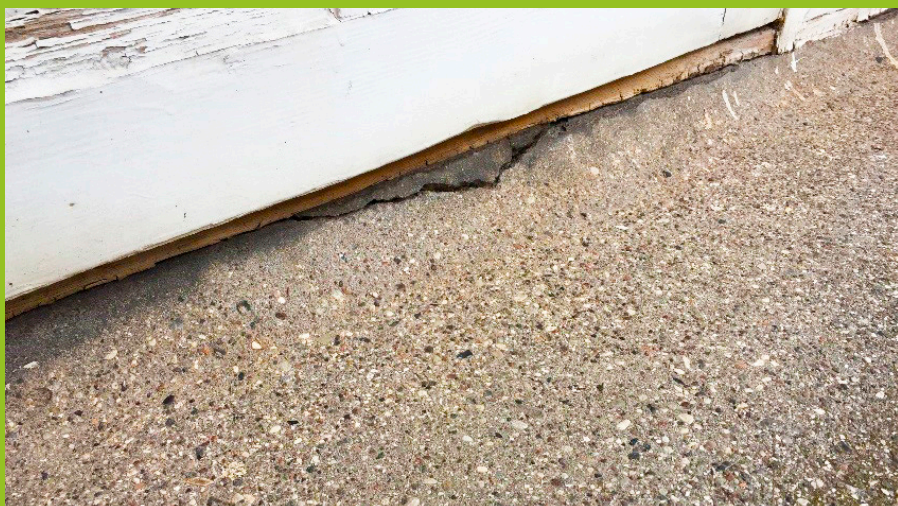
Figur 5: Øverst: Defekt fuge under udgangsdør til altan. Øget adgang for fugt til området under døren, hvorfor eventuelle udliggerjern, som er placeret i dette område, vil være ekstra udsatte for korrosion. Nederst: Altan, hvor tætning mod facade og under dørparti er udført med hulkehl. Der ses her revne i hulkehlen under dørparti, hvorfor dennes funktion lokalt vil være forringet.
