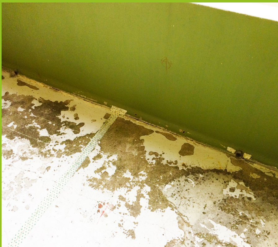
Figur 11: Udslidt/defekt belægning på overside af altan medfører øget opfugtning af betonen.
