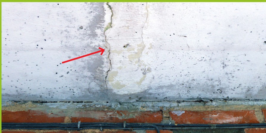
Figur 3: Altan med udliggerjern, hvor der ses revner og opbuling i undersiden, som er orienteret vinkelret på facaden. I dette tilfælde er revnen opstået som følge af korrosion på et overliggende udliggerjern. Denne type revner og udbulinger kan både optræde i altanens over- og underside afhængig af, hvor på udliggerjernet korrosionen foregår. Bemærk, at der ikke ses rødbrune udfældninger i forbindelse med revnen, selv om der foregår korrosion.
