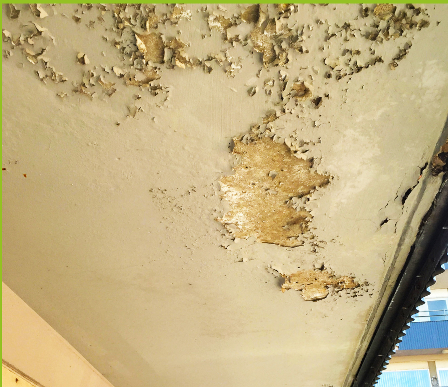
Figur 4: Afskalninger af maling og hvide udfældninger på underside af altan, hvilket indikerer, at der foregår en utilsigtet fugtpåvirkning af betonen.
