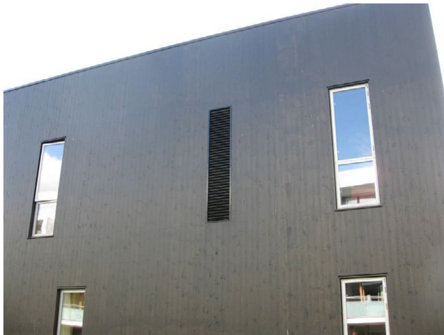
Figur 8. Udeluftindtag i 1. sals højde i bygningens vestlige ende.
