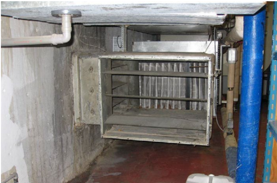
Figur 52. Indtagskanalens udmunding i kælderen. Kanalen udmunder i venstre side bag det åbne spjældet. Spjældet er normalt lukket.
