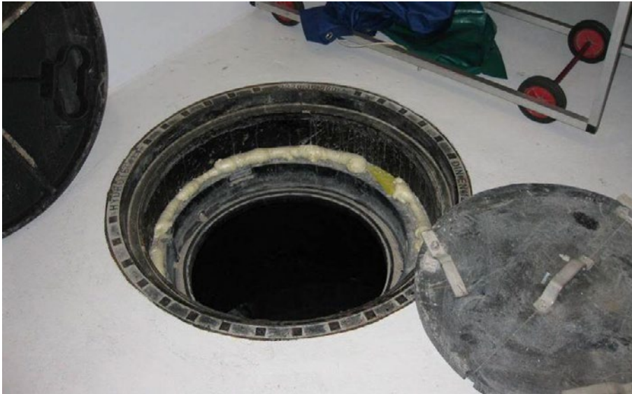
Figur 11. Kondensbrønd i bygningens vestlige ende. Brønden er indendørs. Til højre ses det nederste dæksel, som slutter lufttæt. Til venstre anes det overliggende støbejernsdæksel.
