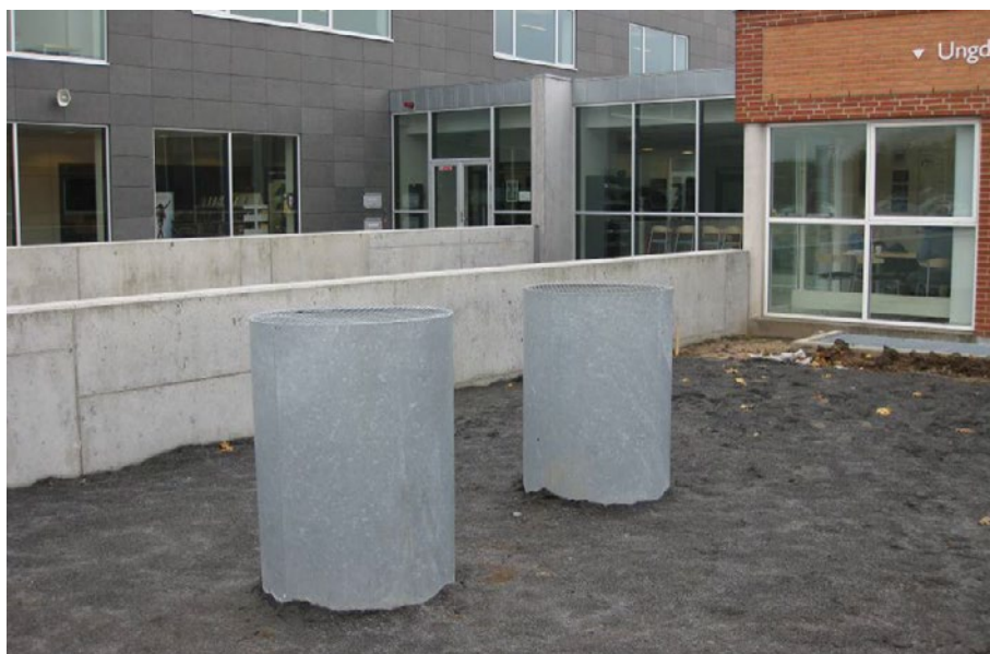
Figur 25. Afkast- og indtagsskorstene i terræn som de ser ud nu (okt. 2011). Begge kanaler er afsluttet med en galvaniseret rist med en maskevidde på ca. 30x30 mm.
