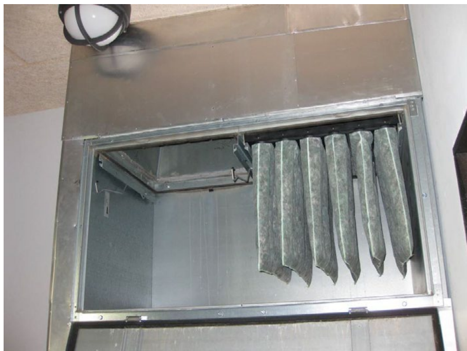
Figur 9. Filter (klasse F7) i udeluftindtaget i stueetagen i bygningens vestlige ende. Én filtersektion er taget ud.
