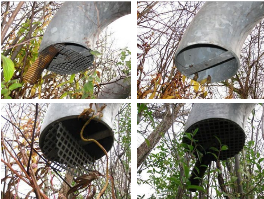
Figur 68. Østside. Udeluftindtag. Slangerne øverst til venstre og nederst til højre er forbundet med dykpumperne i inspektionsbrøndene, se figur 66 og figur 67.
