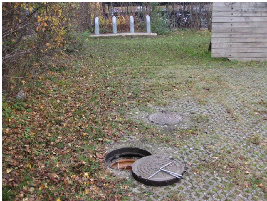
Figur 65. Østside. Inspektionsbrønde. I baggrunden ses udeluftindtagene.
