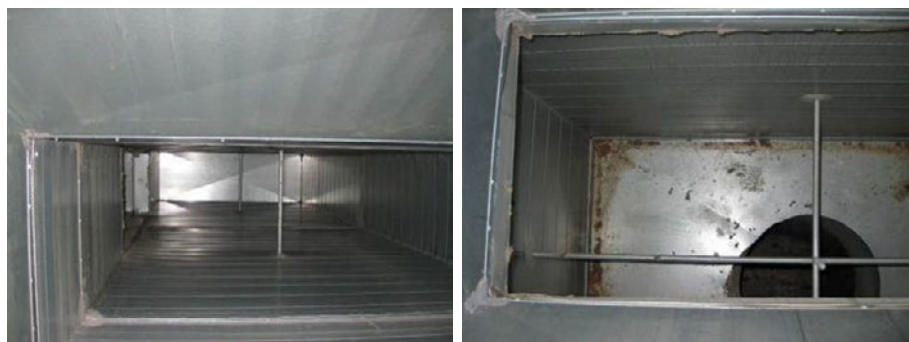
Figur 10. Til venstre: Kig opad i indtagskanalen fra filtersektionen i stueetagen mod udeluftindtaget i 1. sals højde. Til højre: Kig nedad i indtagskanalen fra filtersektion i stueetagen mod bøjning under gulv.
