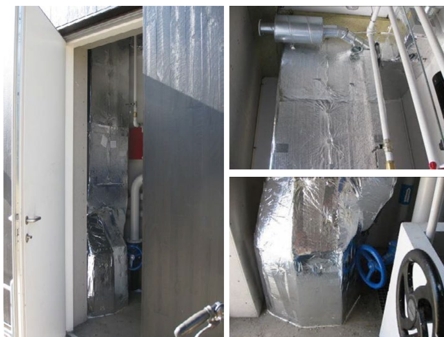
Figur 16. Til venstre: Dør til sprinklercentral. I rummet ses indtagskanalen, som går lodret fra kanal i jorden til teknikrummet på 1. sal. Til højre: Kig opad og kig nedad på indtagskanalen i sprinklercentralen.
