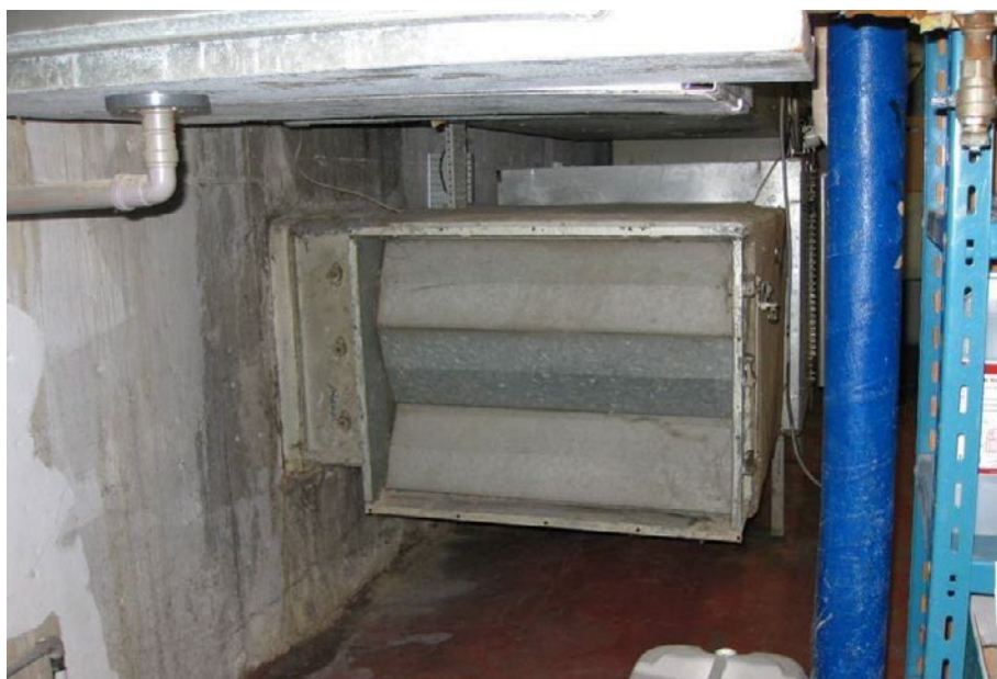
Figur 51. Indtagskanalens udmundning i kælderen. Kanalen udmunder bag det lukkede spjæld. Spjældet, som stammer fra en tidligere installation, er normalt lukket.
