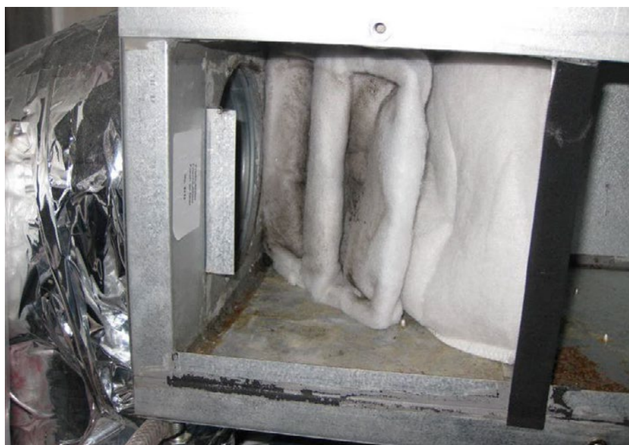
Figur 46. Filter i udeluftindtaget, demonteret.
