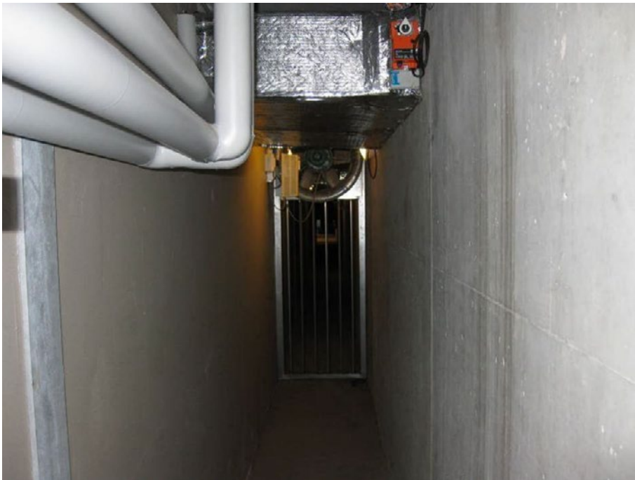
Figur 39. Ventilationskælder med spjæld og hjælpeventilator.
