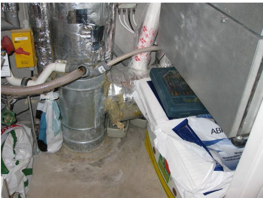
Figur 44. Indtagskanalens udmundning i lejlighedens teknikrum og tilslutningen til det væghængte ventilationsanlæg, som ses til højre.
