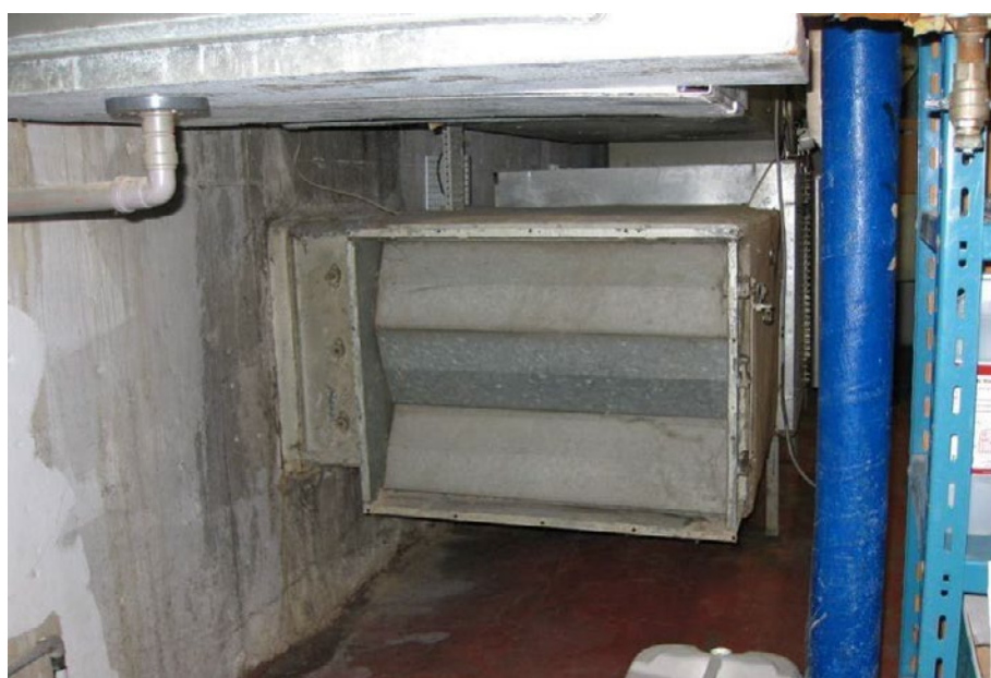
Figur 51. Indtagskanalens udmunding i kælderen. Kanalen udmunder bag det lukkede spjæld. Spjældet, som stammer fra en tidligere installation, er normalt lukket.
