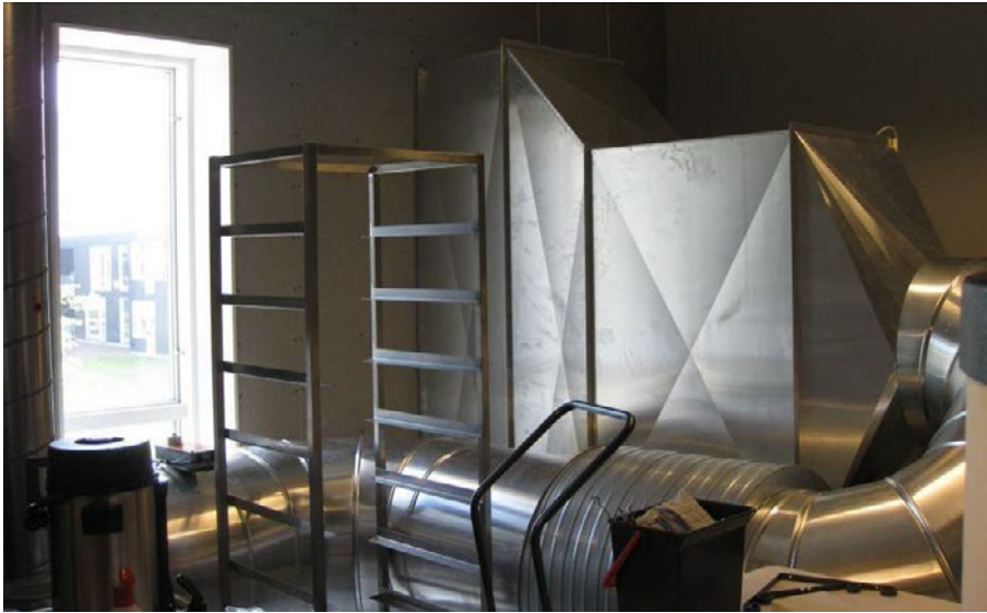
Figur 17. Teknikrum. Udeluftindtag i bygningens østlige ende.
