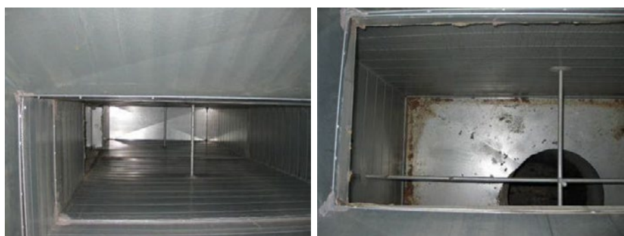
Figur 10. Til venstre: Kig opad i indtagskanalen fra filtersektionen i stueetagen mod udeluftindtaget i 1. sals højde. Til højre: Kig nedad i indtagskanalen fra filtersektion i stueetagen mod bøjning under gulv.
