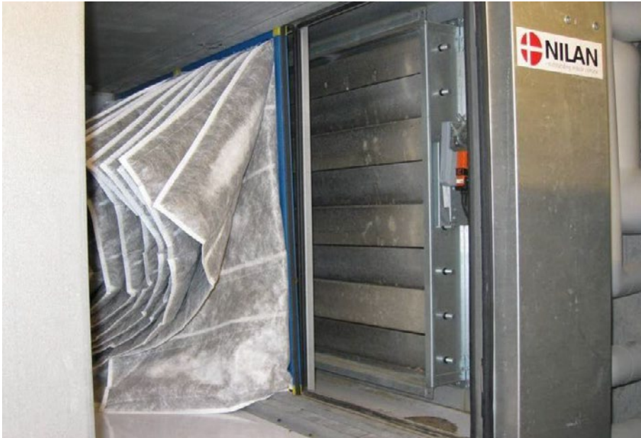
Figur 29. Indtagskanal (til højre bag det lukkede spjæld), spjæld og filter, se figur 23. Én filtersektion er fjernet. Filtret er klasse F7. Ventilationsaggregatet befinder sig til venstre uden for billedet.
