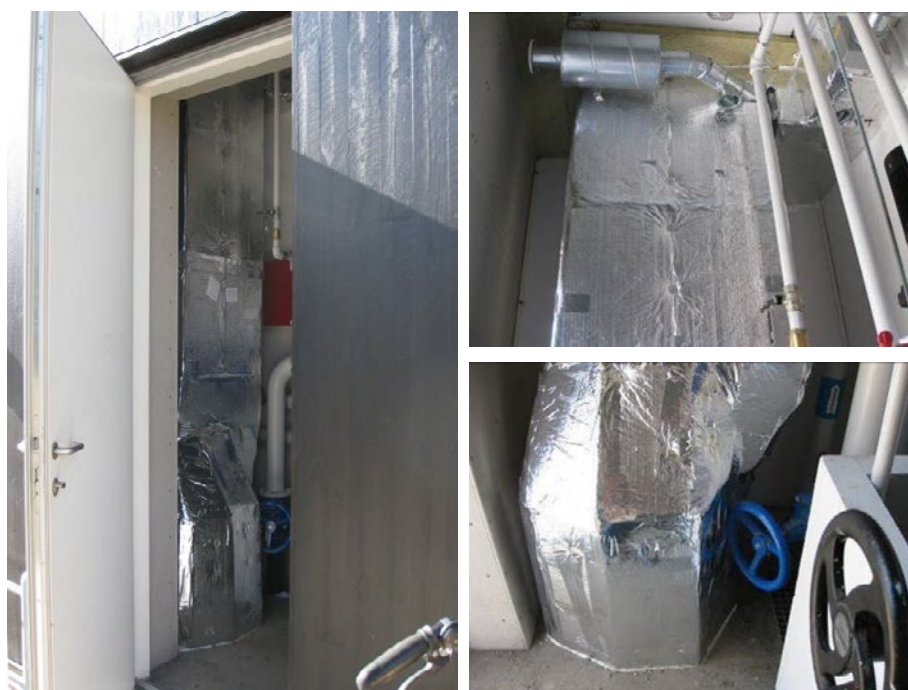
Figur 16. Til venstre: Dør til sprinklercentral. I rummet ses indtagskanalen, som går lodret fra kanal i jorden til teknikrummet på 1. sal. Til højre: Kig opad og kig nedad på indtagskanalen i sprinklercentralen.
