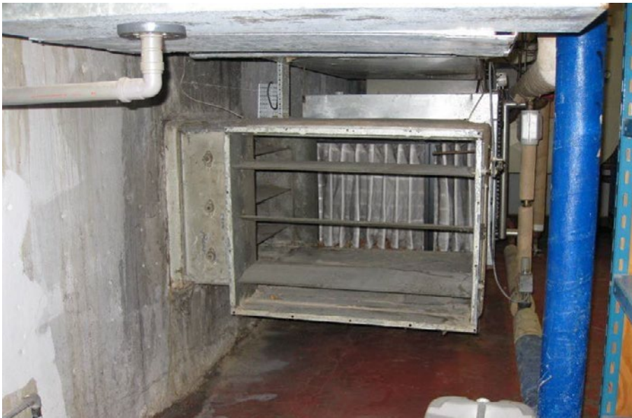
Figur 52. Indtagskanalens udmunding i kælderen. Kanalen udmunder i venstre side bag det åbne spjæld. Spjældet er normalt lukket.
