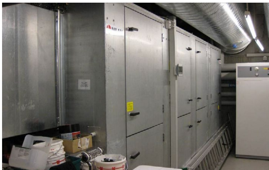
Figur 28. Ventilationsanlæg i kælderen. Indtags- og afkastkanalerne går henholdsvis til og fra anlægget i den fjerneste ende. I forgrunden til venstre er indblæsning til bygningen.
