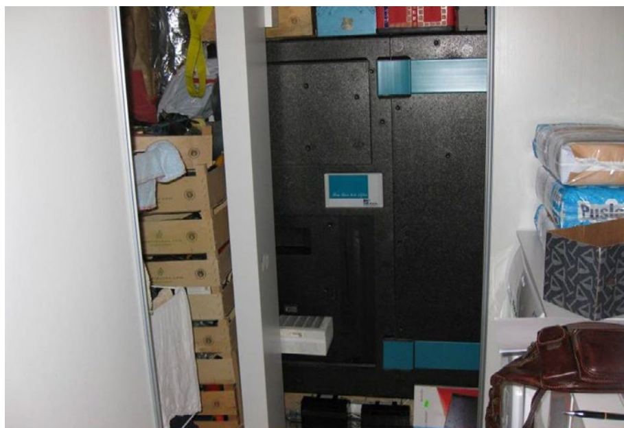
Figur 74. Ventilationsanlægget. Den hvide "skuffe" omtrent midt i billedet er udeluffiltret.
