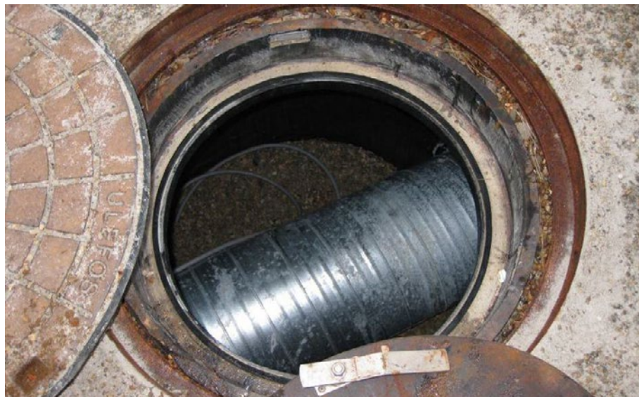
Figur 14. Kondensbrønden i bygningens østlige ende, se figur 7.
