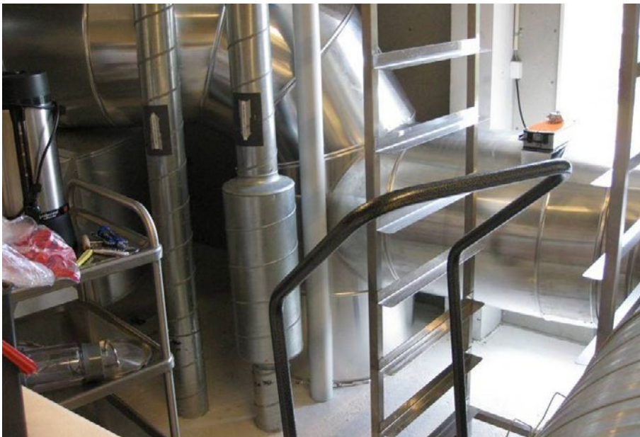
Figur 18. Teknikrum. Den store, vandrette kanal til højre er udeluftindtaget i bygningens østlige ende. Den store, lodrette kanal midt i billedet udeluftindtaget i bygningens vestlige ende efter vandret passage under bygningen og lodret passage gennem sprinklercentralen.
