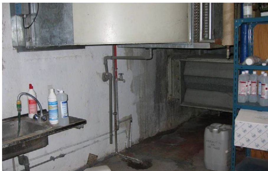
Figur 50. Indtagskanalens udmunding i ventilationsrummet i kælderen. Kanalen udmunder bag det lukkede spjæld til højre.
